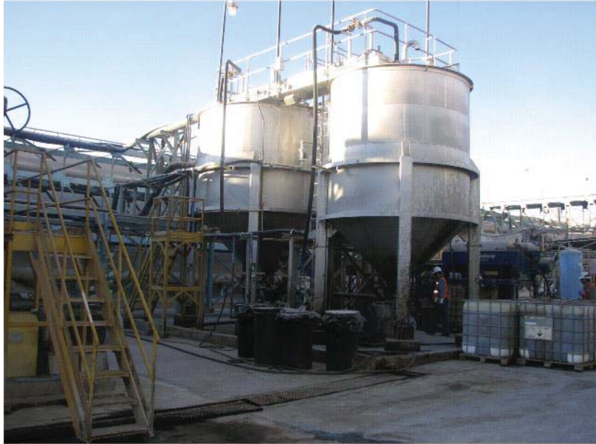
Figura 3-28. Vista general sistema de pruebas
